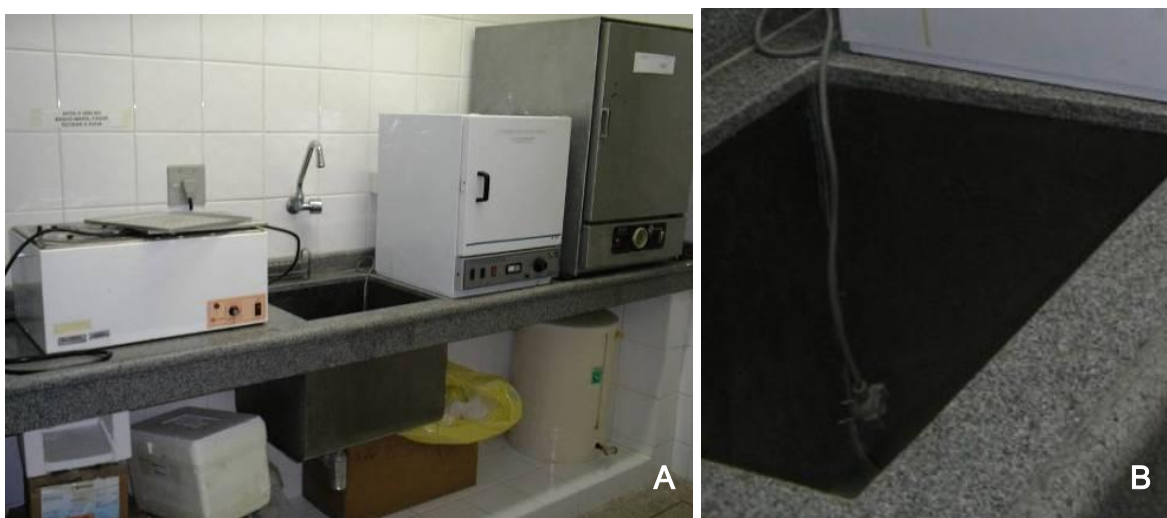
Figura 34 (A e B) – A -Equipamentos elétricos muito próximos a pia e a água corrente; B – Tomada dentro da pia
