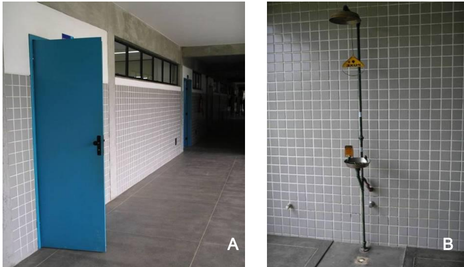
Figura 31 (A e B) - A - Porta abre para fora; B - Chuveiro e lava olhos.
